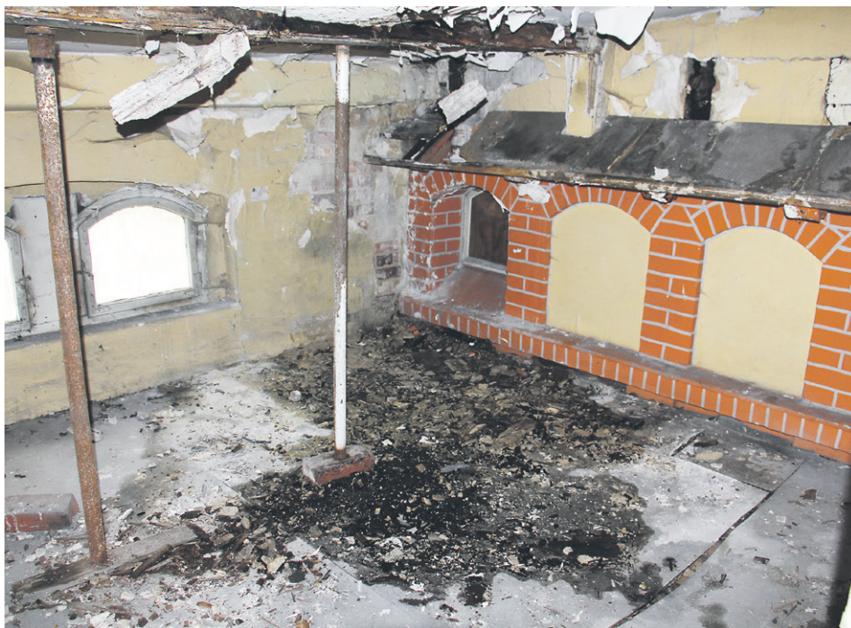
Budynek przez lata popadł w ruinę
